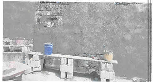
FOTO 4: ENSABIETADO EN TAPIAL DE MURO PERIMETRAL
